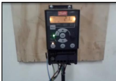
Figura 1: Variador de frecuencia
